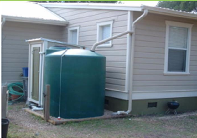
تجميع مياه الأسطح
